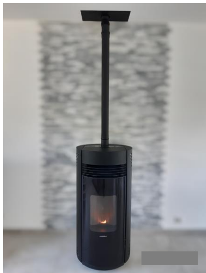
Face tubage visible jusqu'au plafond
