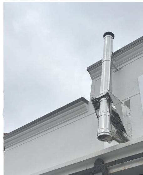
Sortie de fumée
